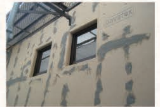
外壁にはセルロースファイバーの充填断熱と木質断熱材
