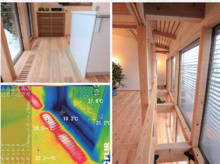
床下で暖められた空気は、床全体を温め窓下に設けたガラリからリビングへ。温かい空気は、さらに吹き抜けを通して2Fへ、家全体をムラなく温めながら排出されるパッシブ換気。
