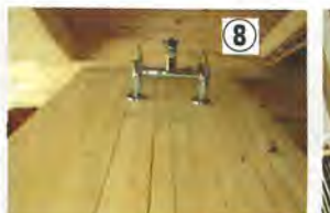
⑧ 水道管と躯体壁の取り合い部。配管に専用の管を埋め込んでおく
