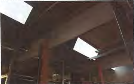
2階建て建物の北面屋根から光を集め、1階倉庫の中央におくる「光の暖炉」。南北面開口からの採光をあわせれば、日中の倉庫の照明は必要ない
